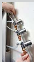
trappe de visite pour accès direct à la robinetterie
